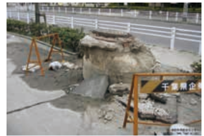
液状化により浮き上がった マンホールの様子 (東日本大震災)
