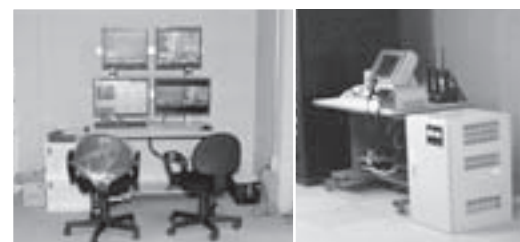
危機管理ベースに設置した、高所カメラのモニター(写真左)と防災無線装置(写真右)
