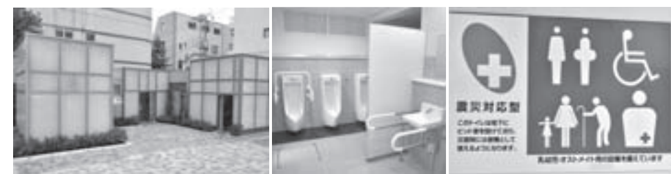
まち歩きトイレ業平橋の外観 快適なトイレ空間 分かりやすいピクトでご案内
