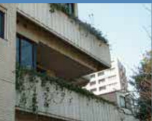
すみだボランティアセンター 区内で初めてベランダ緑化雨水利用システムが取り入れられました。2・3階のベランダのコンテナボックスで雨水を浄化しています。トイレや冷却ポンプ給水にも雨水を利用しています。1985年竣工。
