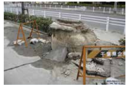
因液化而浮出水面的井盖情况 (东日本大地震)
