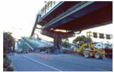
붕괴된 한신 고속 도로
