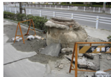
因土壤液化而 浮出水面的人孔（蓋） （東日本大地震）
