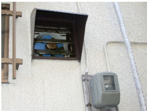
換気扇ダンパーが閉まらない
