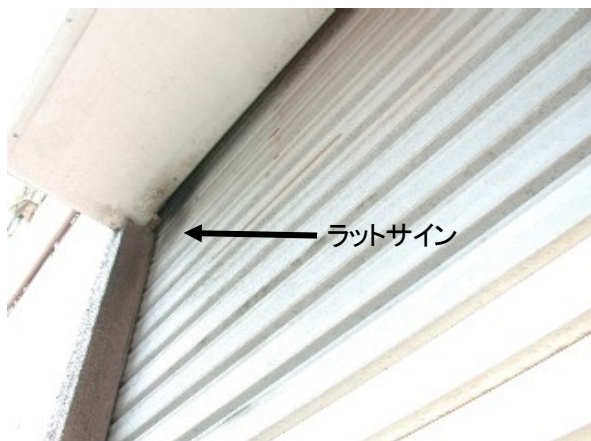
シャッター上部隙間から侵入 (ラットサインが見える)
