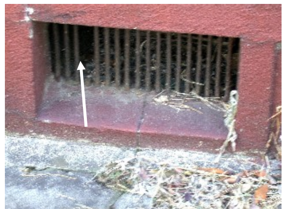
床下通風口の格子破損
