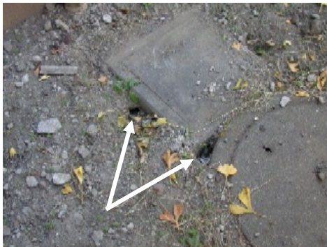
下水マンホール脇の穴
