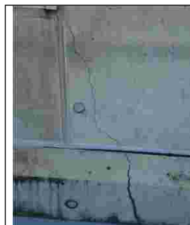
【外壁コンクリート躯体】 ひび割れ
