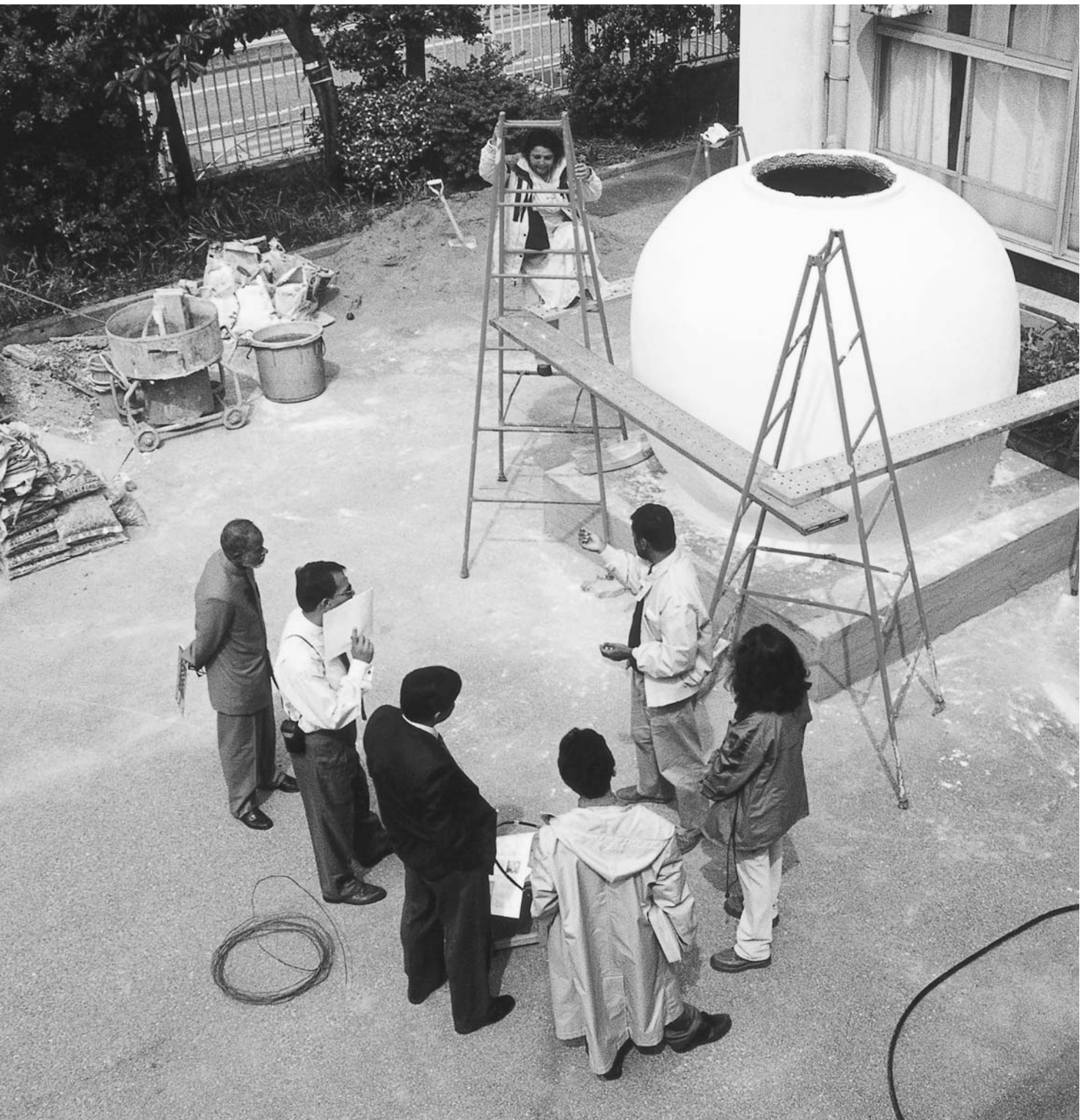
(仮称) 環境学習センターに設置中の雨水タンク ーパンプキンタンクー (旧文花小学校) ※1面に掲載する写真を募集しています。
