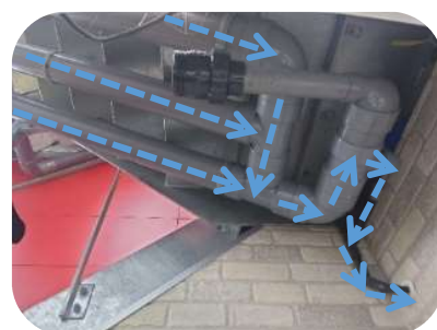
パイプ型タンクから建物内への接続
