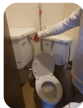
雨水用・水道水用のトイレタンク （雨水用をメインで使用）
