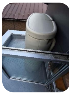
2階テラスのタンク
