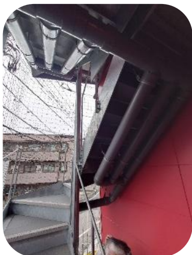
階段下のパイプ型タンク
