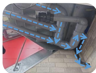
パイプ型タンクから建物内への接続
