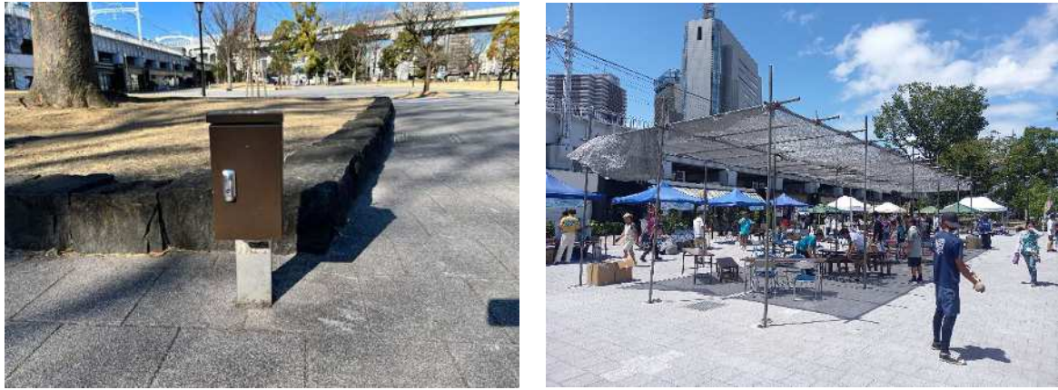
図 49 イベント支援施設の例(左:電気設備、右:単管固定用さや管の使用状況)
