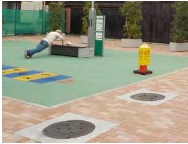
マンホールトイレ(曳舟やすらぎ公園)
