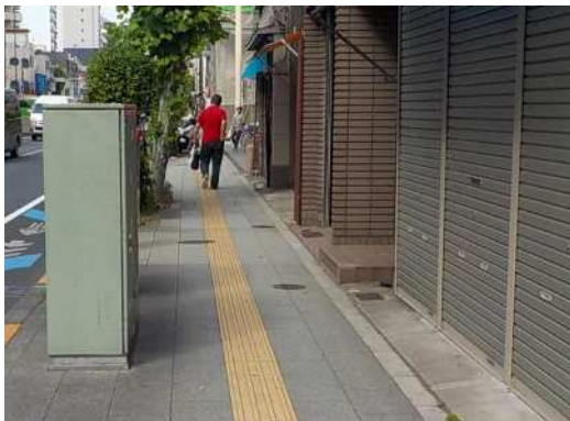
写真 左：地上機器により歩道空間を狭めている事例
