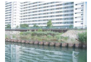
護岸未整備箇所
