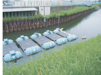
水質浄化施設
