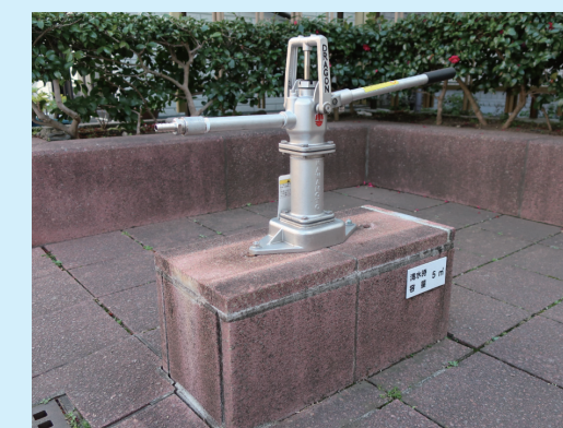
●新しくなったさくら一休の雨水ポンプ
